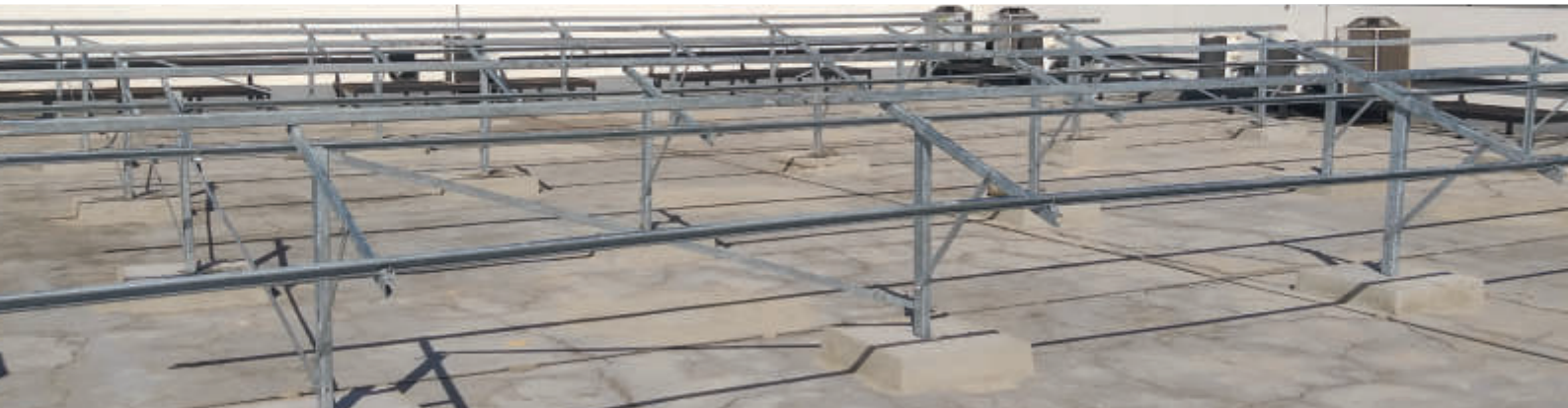
ESTRUTURA DE FERRAGEM MONO APOIO APLICADO EM LAJE COM USO DO TFV-GF-U
